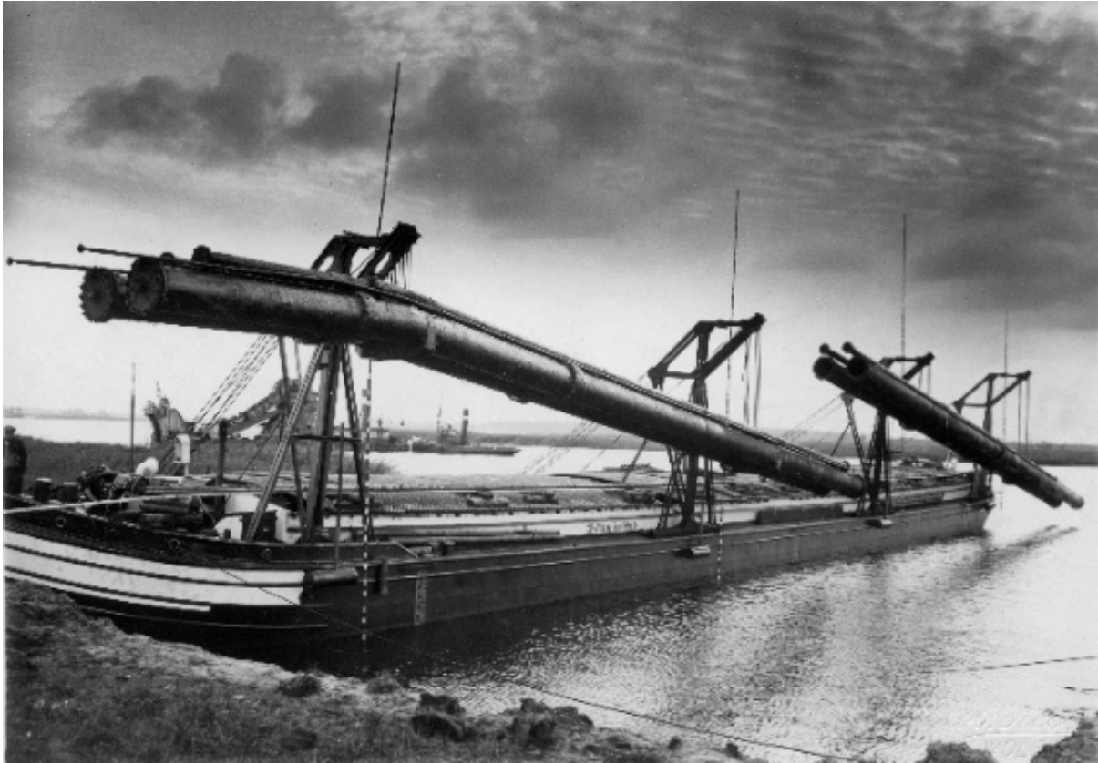
Die Verlegung des Dükers mit der Gas- und Wasserleitung unter die Peene (Fotos Robert Hess 19, 1942)
